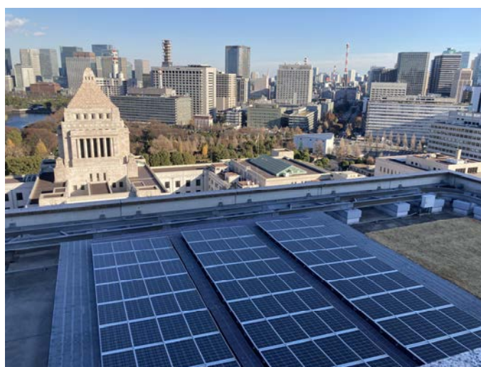
議員会館屋上の太陽光パネル
