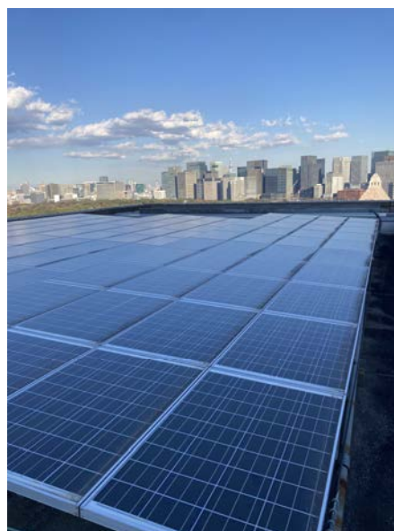
議員会館屋上の太陽光パネル
