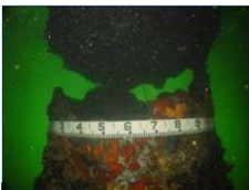
【鋼管杭の腐食の進行】
