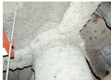
吹付けアスベスト
