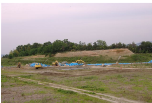
約15万トンのフェロシルトが不法投棄された愛知県瀬戸市幡中町。撤去作業は2013年まで続く。
